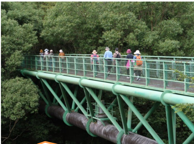
日野 塩滝橋 上流の水管橋
